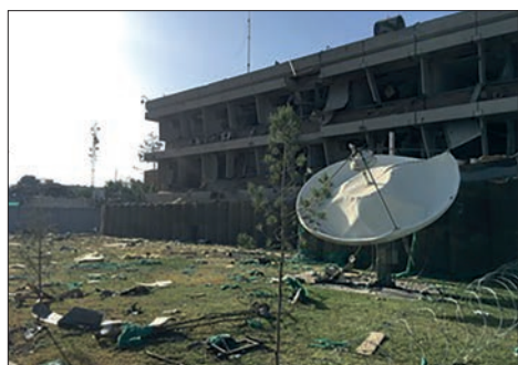
Schaden am Kanzleibäude der DEU Botschaft unmittelbar hinter der Schutzmauer
