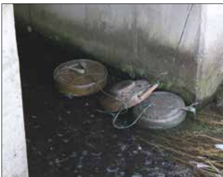
Sprengfalle unter der Brücke
